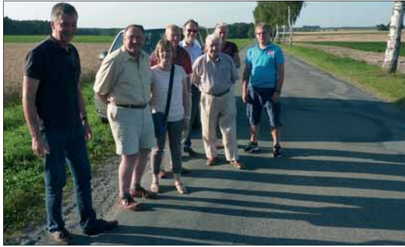
Begutachtung des Gemeindeverbindungsweges von Radenbeck zur Bundesstraße.
